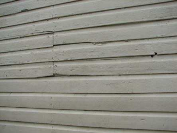
Laajennusosan päädyn verhous on huonokuntoinen.
