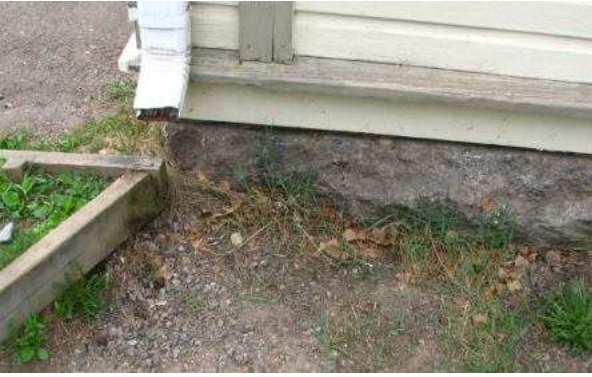
Sadevesiä ei ole johdettu pois rakennuksen vierestä.
