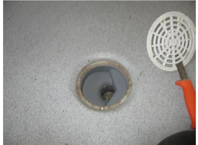
56. Pesuhuoneen lattiakaivo on kuiva
