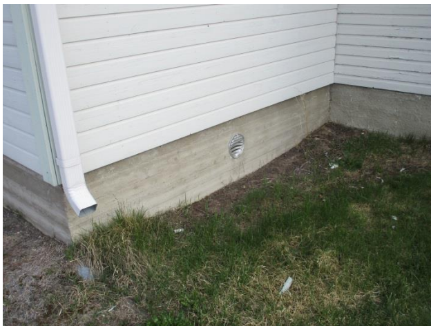
23. Sokkeli on pinnoittamatta. Vesi jää seinän viereen, seinän vieressä on painanne
