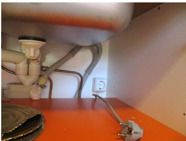
35. Keittiön allaskaappi, astianpesukoneen poistoputkeen on asennettu poistoputken kaarituki
