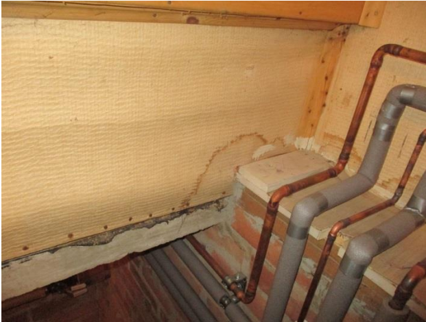
31. 1. kerroksen lattian rajassa on kosteusjälkiä
