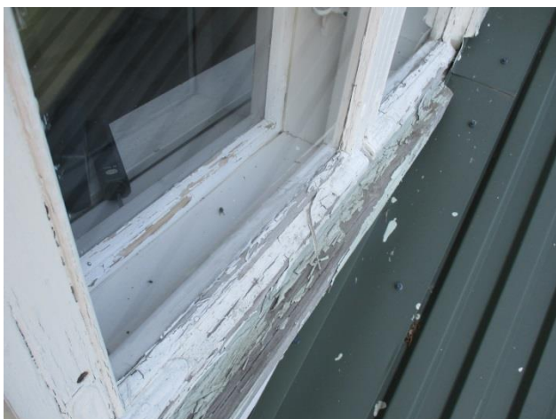
41. Vanhan osan yläkerran ikkunan ja seinän liittymäkohta. Ikkunoiden maalipinta on heikko
