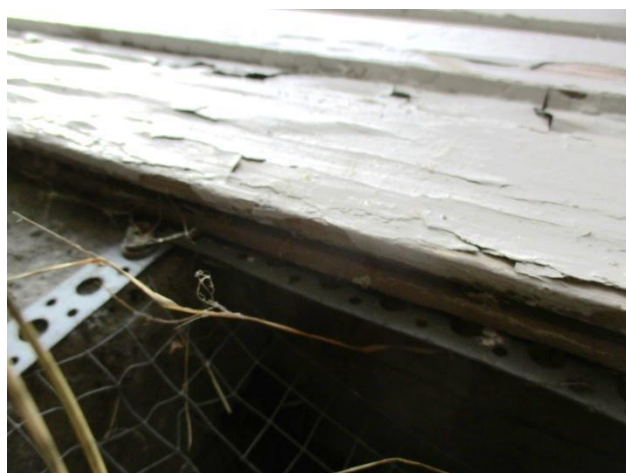
12. Vanhan osan ulkoverhouksen alta puuttuu taustatuuletusrako
