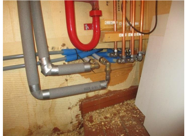
32. Putkistot vanhalta osalta laajennusosalle
