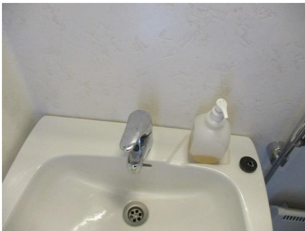
11. Käsienvesualtaan takaa puuttuu silikonisauma
