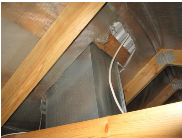
59. Hormin ja aluskatteen liitos ei ole tiivis
