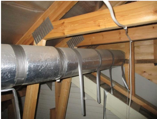
61. Teippaukset irtoaa eristeiden päältä yläpohjatilassa. Putken kannakointi on puutteellista
