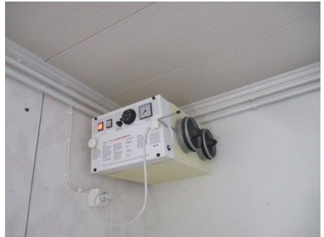
22. Ilmanvaihtokone ulkoseinällä, tuloilmalämmitys
