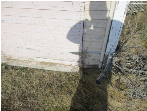
3. Rakennuksessa ei ole sadevesikouruja. Vedet tulevat suoraan maahan. Puurakenteet ovat lähes maata vasten
