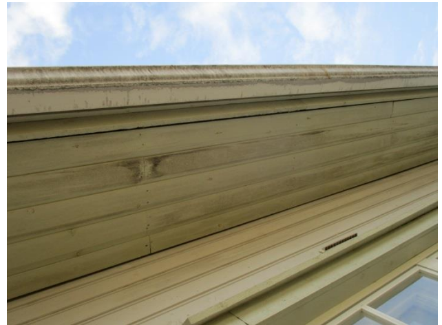
26. Räystäspohjassa ei ole tuuletusaukkoja, maalipinta on huonokuntoinen
