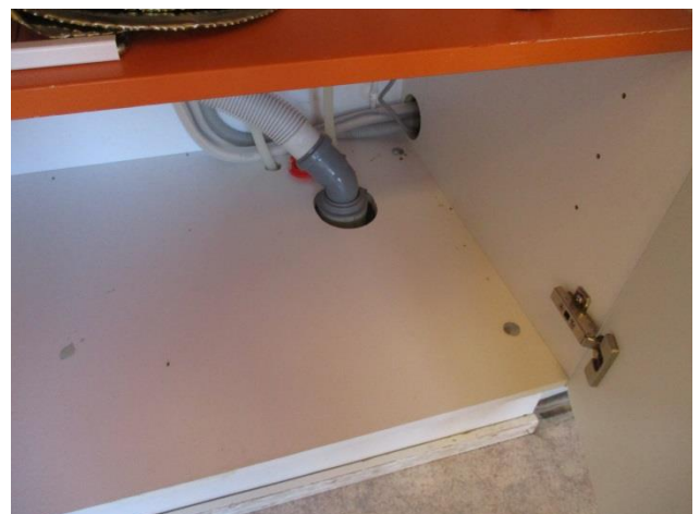
36. Allaskaapin pohja ei ole tiivis
