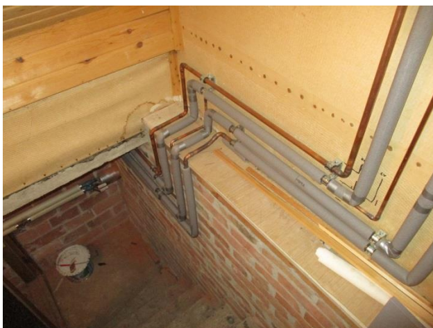
29. Kellarin portaikossa on putkia
