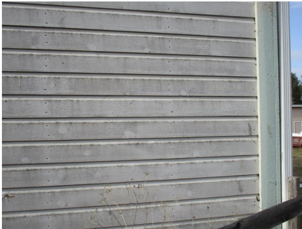
25. Rakennuksen ulkoverhous on huolto- maalauksen tarpeessa
