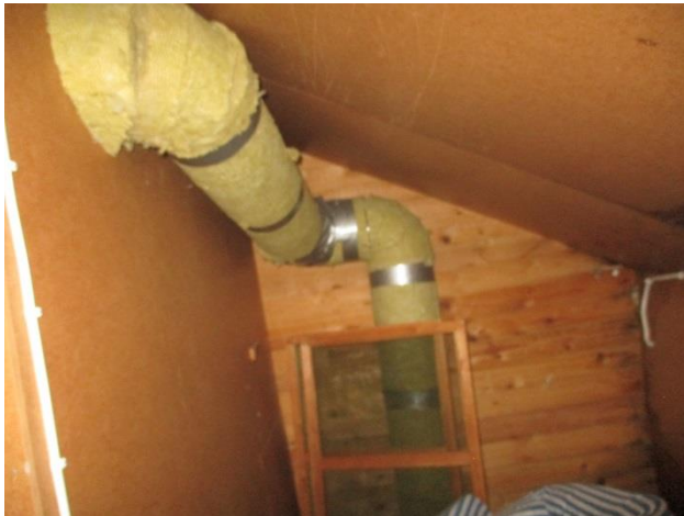
21. Putkien eristykset ovat kunnossa
