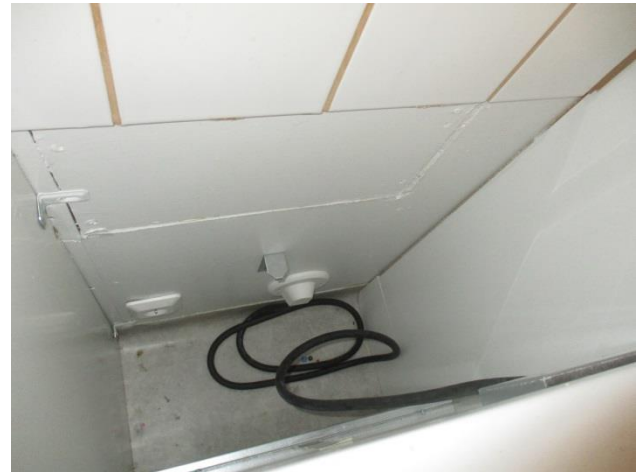
8. Lieden taakse on asennettu kaatumisen estävä rauta
