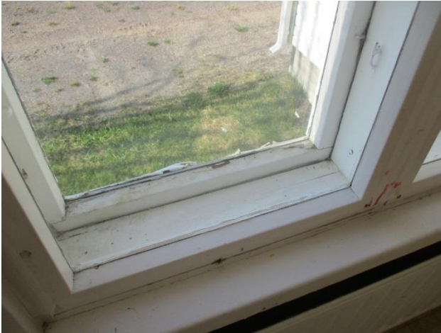
43. Vanhan osan ikkunoiden maalipinta on kulunut
