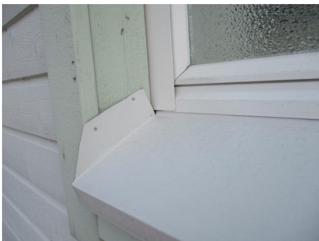
17. Laajennusosan ikkunat ovat hyvässä kunnossa. Vesipellin väliin pääsee vesi päädystä
