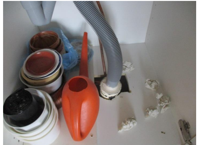
8. Kaapin pohja ei ole tiivis
