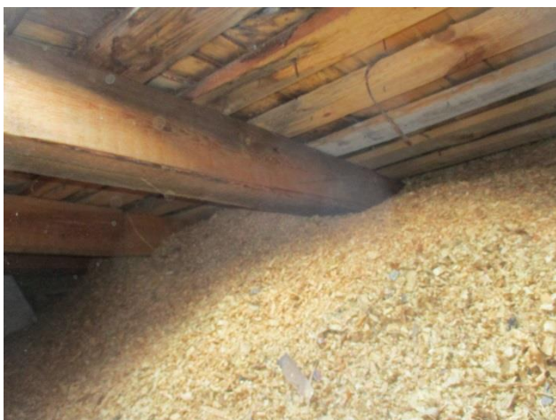
49. Katon suuntaisen osan tuuletus on tukittu. Puuosissa on tummumista
