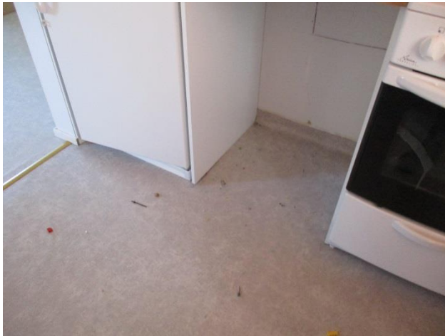
7. Jääkaapin alta puuttuu vedenvuotosuoja
