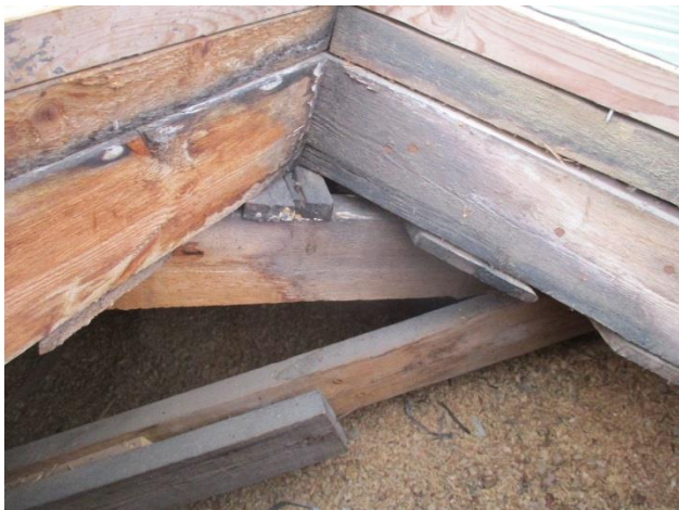
43. Luukku yläpohjatilaan vesikatolta. Luukussa on kosteusjälkiä
