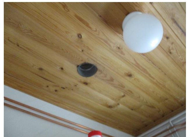
4. Venttiili puuttuu ilmanvaihtoputkesta
