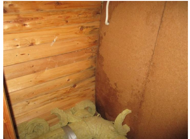
22. Nurkassa on kosteusjälkiä
