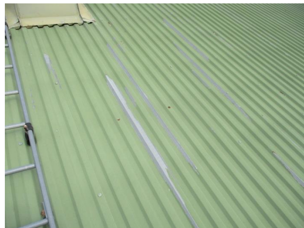
36. Katolla on kulunut maalipinta
