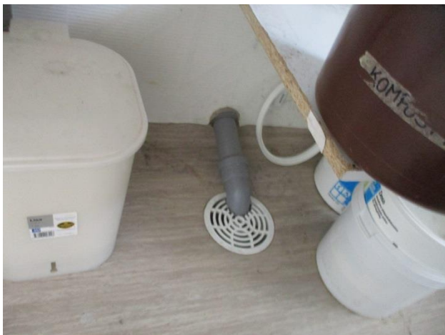
5. Poistoputki tulee seinän läpi siivouskomeron lattiakaivoon
