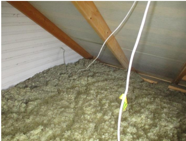
55. Johdot on kannakoimatta yläpohjatilassa
