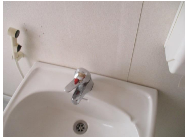
14. Käsienpesualtaan takaa puuttuu silikonisaumaus
