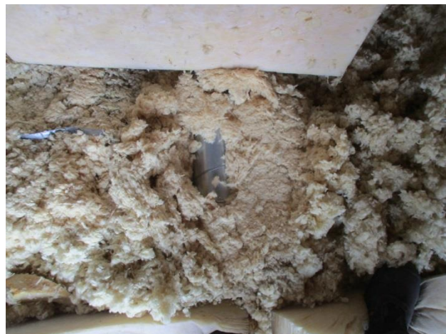
52. Putken ympärillä ei ole tarpeeksi eristettä villan sisällä
