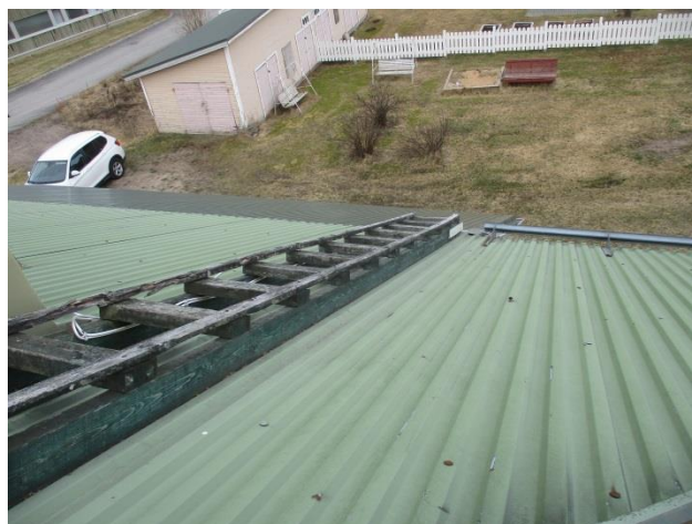
38. Kattotikkaat ovat huonossa kunnossa
