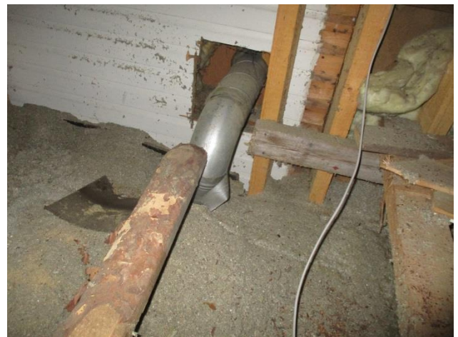
60. Putki on eristämättä yläpohjatilassa
