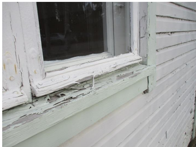
16. Vanhan osan ikkunat ovat osin alkuperäisiä. Maalipinta huonossa kunnossa. Ikkunasta puuttuu vesipellit
