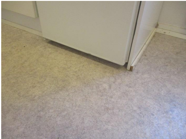
33. Jääkaapin alta puuttuu vedenvuotosuoja
