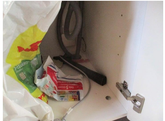
10. Allaskaapin pohja ei ole tiivis
