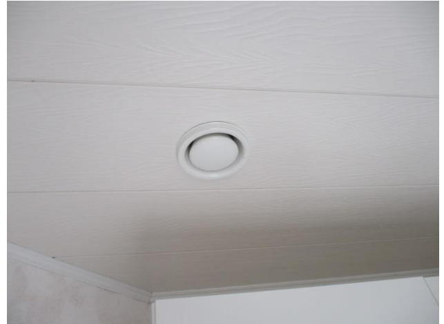
20. Uudella osalla on koneellinen ilmanvaihto
