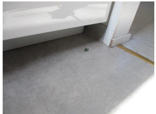
12. Astianpesukoneen alusta on matotettu ja matto on nostettu seinälle
