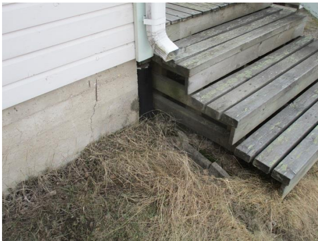
27. Portaat ovat käsittelyn tarpeessa. Kaitteet puuttuvat. Alastulon alla ei ole rännikaivoa
