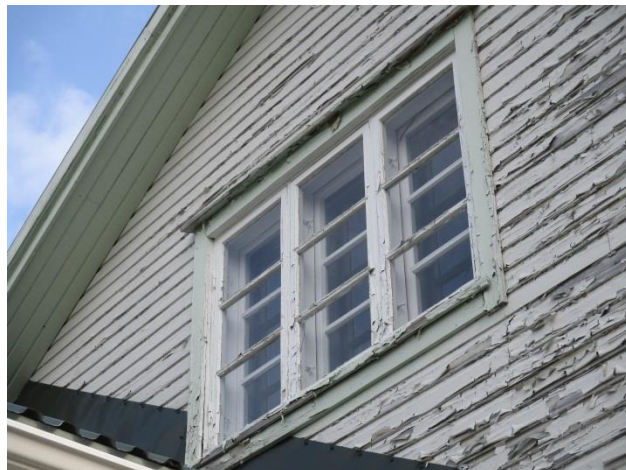
14. Vanhan osan julkisivun verhouksessa on huono maalipinta
