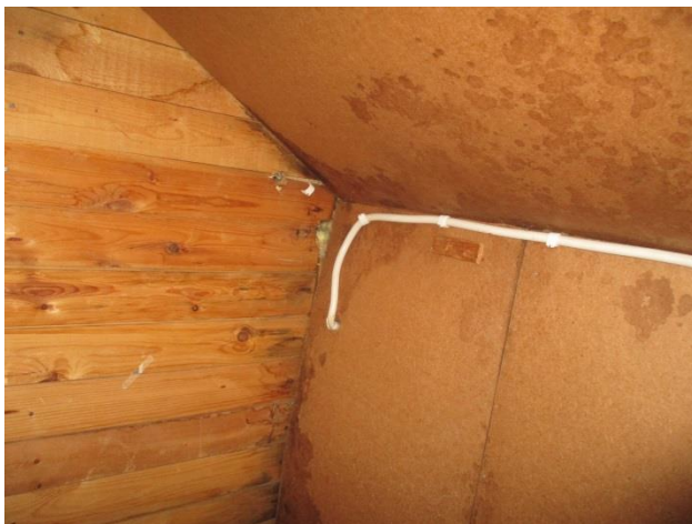
23. ja 24. Ullakon seinissä ja katossa on kosteusjälkiä
