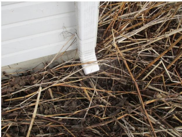
7. Alastulojen alla ei ole rännikaivoja. Kasveja kasvaa liian lähellä rakennusta
