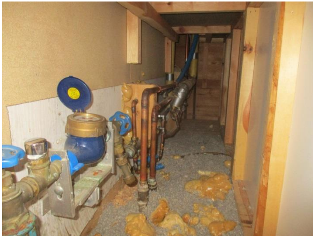
39. Vesimittari, vesijohdot jäätyvät jos kaapin pääty ei ole auki. Putket tulevat lattian kautta
