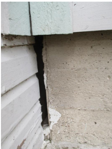
9. Uuden ja vanhan liittymäkohdassa on rako
