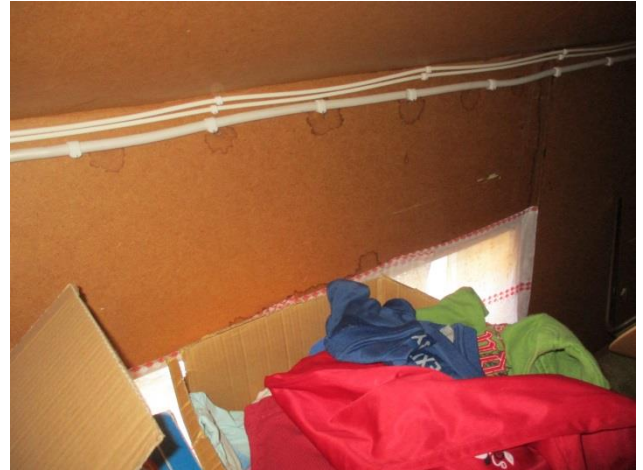
20. Kosteusjälkiä ullakon seinissä
