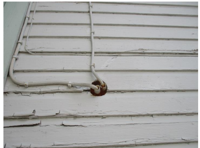
28. Sähköjohtojen läpivienti ei ole tiivis. Jako- rasia puuttuu
