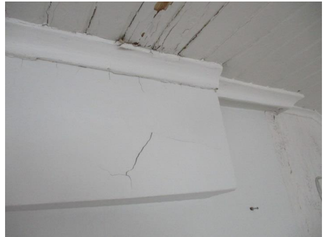
16. Piipussa on halkeama. Katon maalipinta hilseilee, katto on vuotanut piipun juuresta
