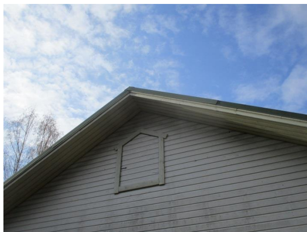
18. Talon päädystä puuttuvat harjatuuletusventtiilit. Yläpohjattilan kulkuluukku päädystä
