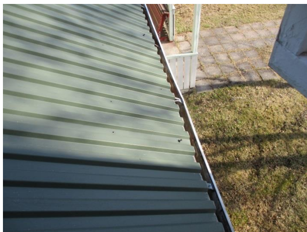
42. Vesikatolla on noussut kiinnitysnauloja ylös kiinnityksestä
