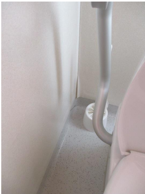
15. Wc:n nurkassa seinätapetti on irti
