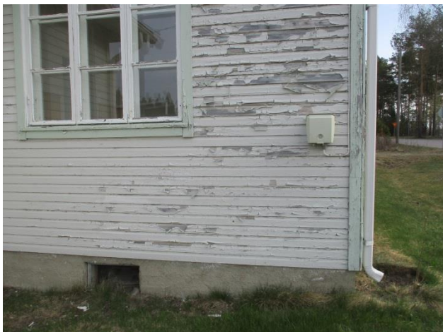
15. Verhouksen maalipinta on huonossa kunnossa
