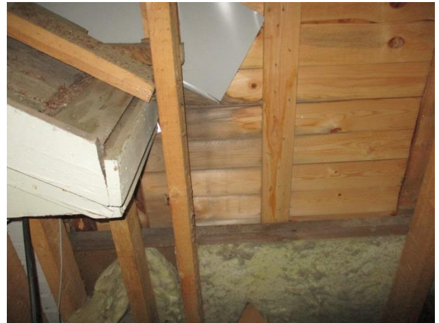
62. Päätyräystä ei ole tiivis, yläpohjaan pääsee eloperäistä roskaa
