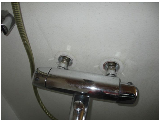
53. Suihkusekoittajan läpivienneistä puuttuvat peitelaiplat
