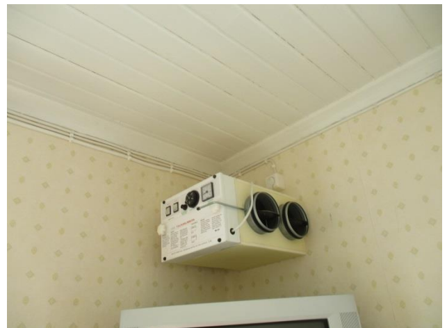
42. Ilmanvaihtokone ulkoseinällä, tuloilman lämmitys
