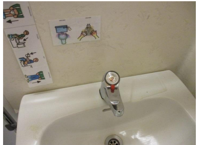
60. Käsienpesualtaan takaa puuttuu silikonisaumaus
