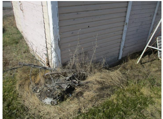
4. Rakennuksen ulkoverhouksen maalipinta on heikko
