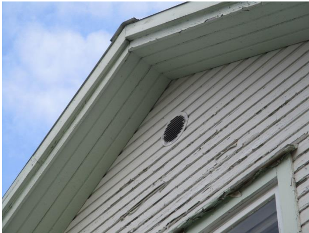
19. Räystäällä ei ole kunnollista tuuletusrakoa Talon päädyssä on yläpohjatilan tuuletussäleikkö vanhalla osalla
