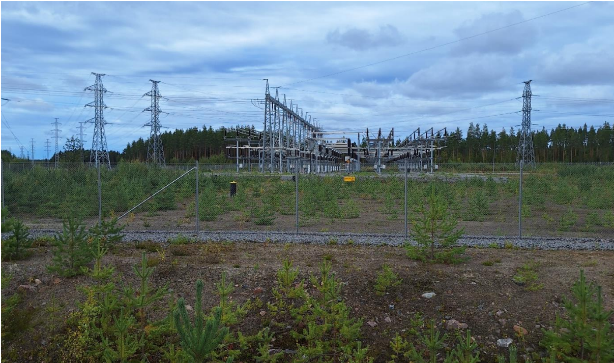
Kuva 16. Alueella sijaitseva sähköasema.
