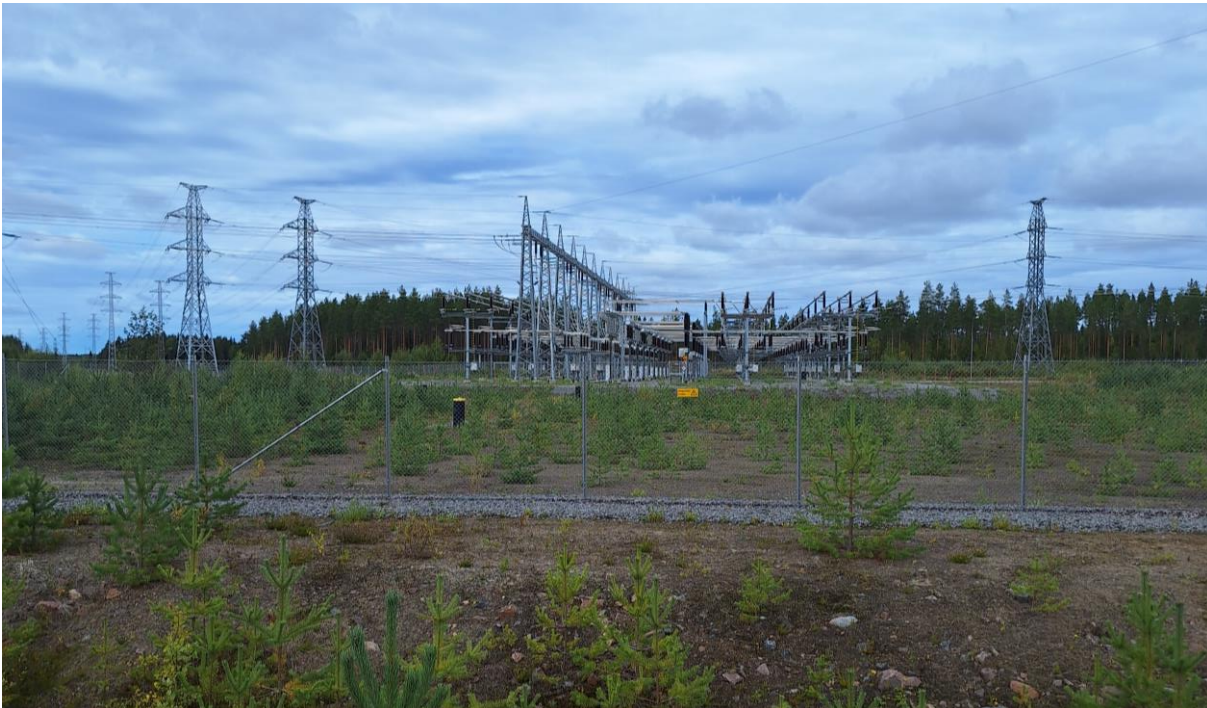
Kuva 22. Siikajoen sähköasema ja siltä lähteviä voimalinjoja.
