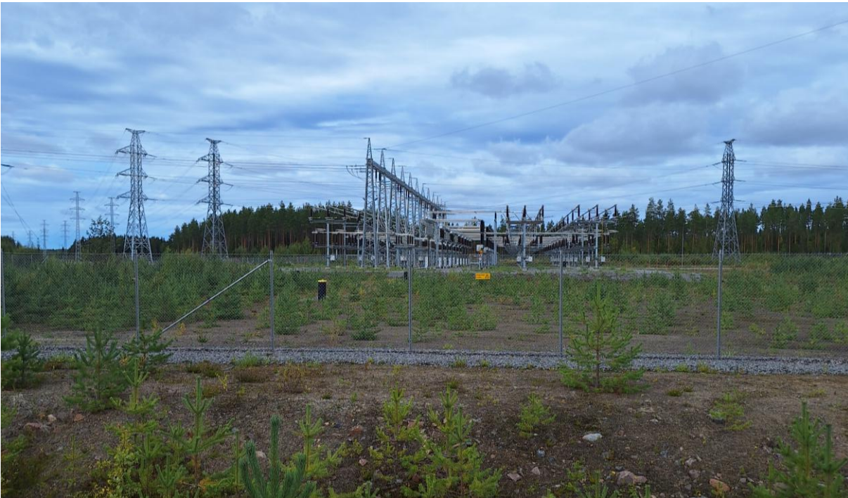
Kuva 23. Siikajoen sähköasema ja siltä lähteviä voimalinjoja.
