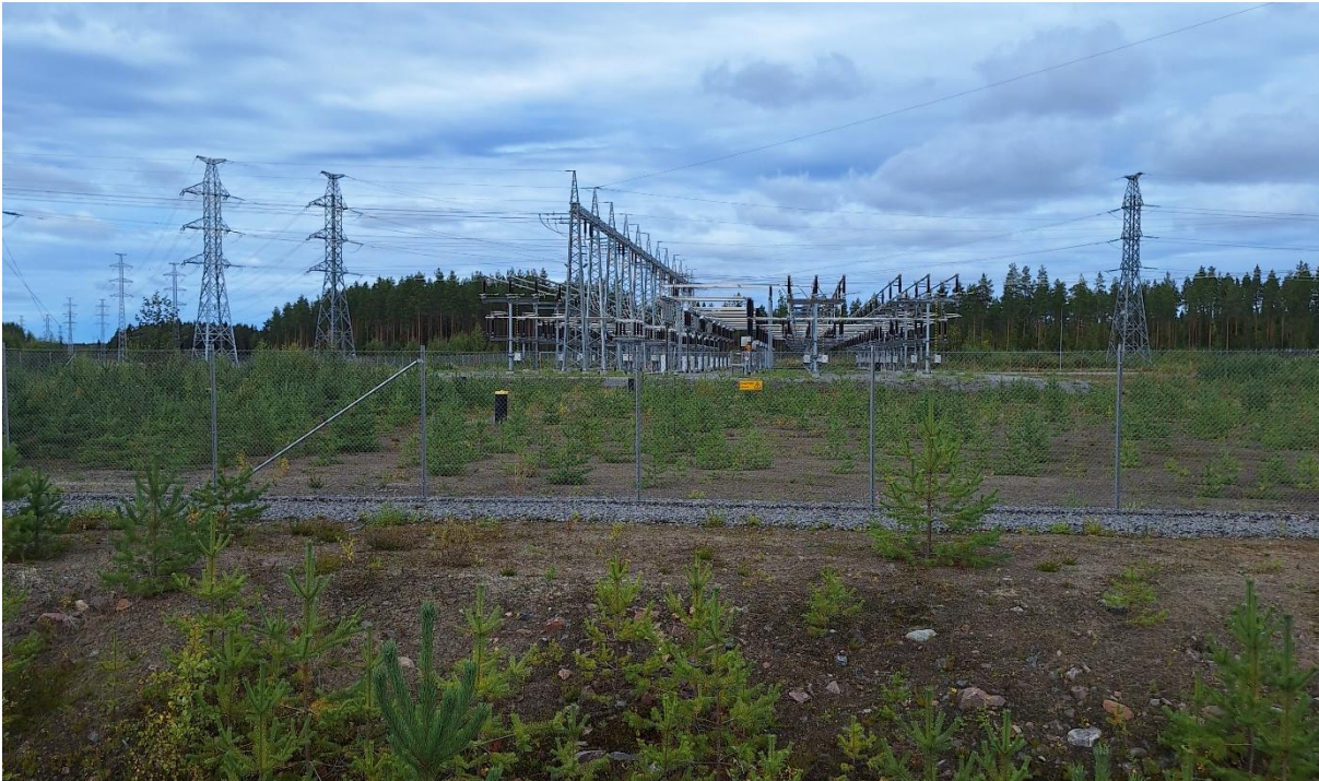
Kuva 16. Alueella sijaitseva sähköasema.
