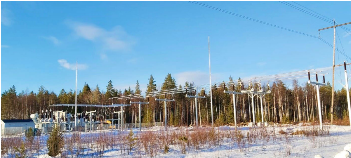
Kuva 2-14. Tuulivoimapuiston sähköasema (© ELTEL Networks Oy).
