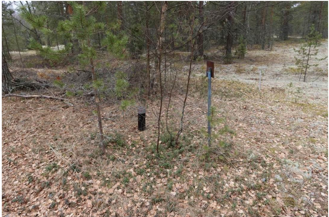
Kuva 11 Vesijohtoverkoston laitteita (Kuva: Kimmo Mustonen 1.5.2025)
